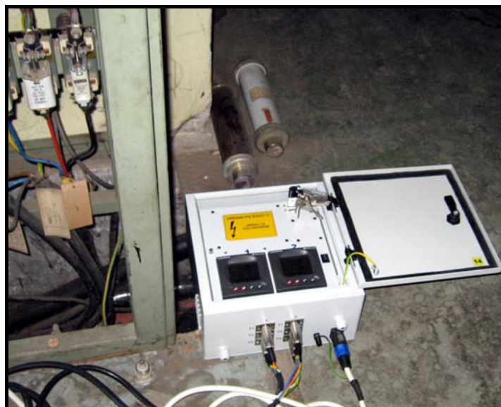
Slika 9. Dvokanalni MIS postavljen u TS 10/0.4 kV
